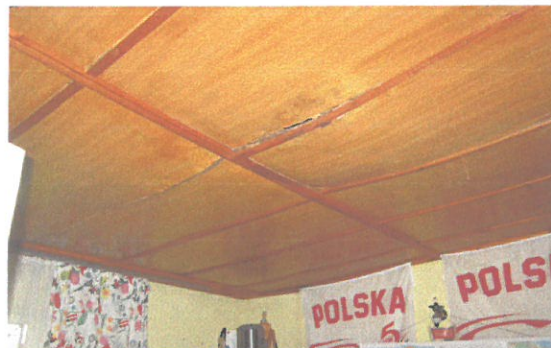
Widok podsufitki uszkodzonej po zaciekach z dachu
